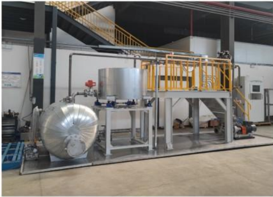
高温液体流量标准装置 High temperature liquid flowmeter calibration device 使用高温油作为介质对高温流量计进行精度测试和稳定性测试
